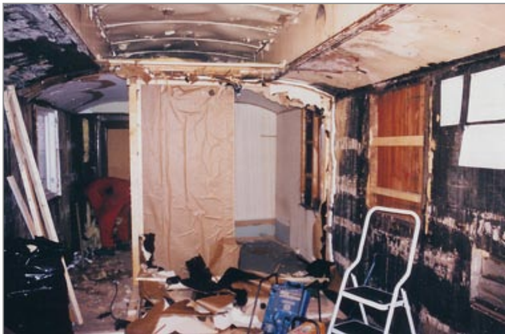
Innvendig var vogna et sørgelig syn når arbeidet startet opp. Etter mange år med dårlig papp på taket har mugg og råte fått godt tak i reisverket og panelen. Over til høyre ser det gamle taket dagens lys igjen etter å ha vært dekket av nye materialer i mange år. Under ser vi det store ekspedisjonsrommet midt i vogna der to soverom og oppholdsrom var bygget inn. Foto: Erling Aasheim
