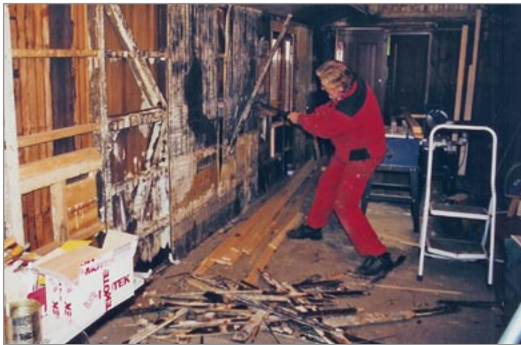
Det var mye råte i tak og vegger, det meste må skiftes ut.
