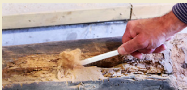
Skader i tømmerstokkene som borebiller har gjort gjennom mange år. Her er det bare tremel igjen inne i stokkene rundt et ytre skall.
